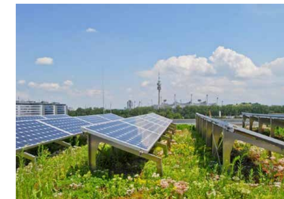
groene daken i.c.m. zonnepanelen
